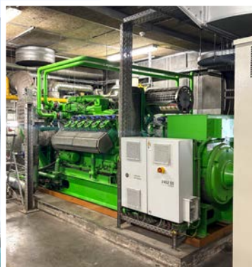
Eingepasst und einsatzbereit: Das BHKW ist startklar.
